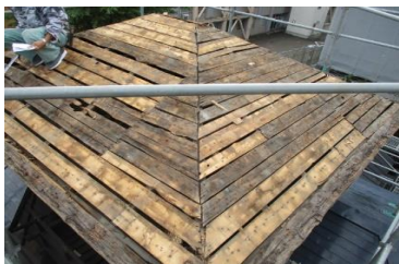
檜屋根野地板(腐食状況)
